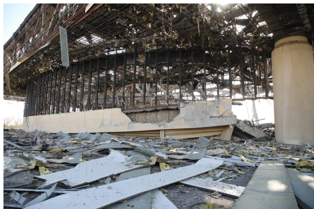
تخریب ورزشگاه آزادی در اثر حملات نظامی
